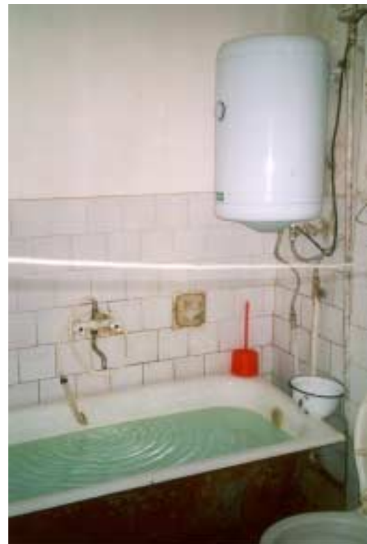
endlich Warmwasser im Altersheim, ein neuer Boiler von uns
