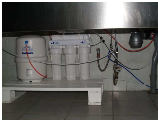
Die Filteranlage für Bujucani
